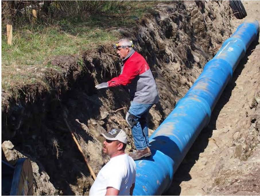
Ende Februar begannen die Vorbereitungen für die Verlegung der Rohrleitungen für das neue Kraftwerk ...
